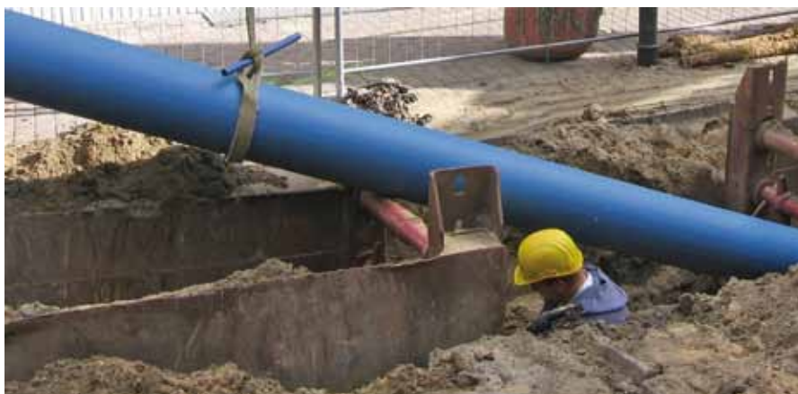
Tubos de esgoto: PP desloca contratipos de cimento e manilha de barro.
