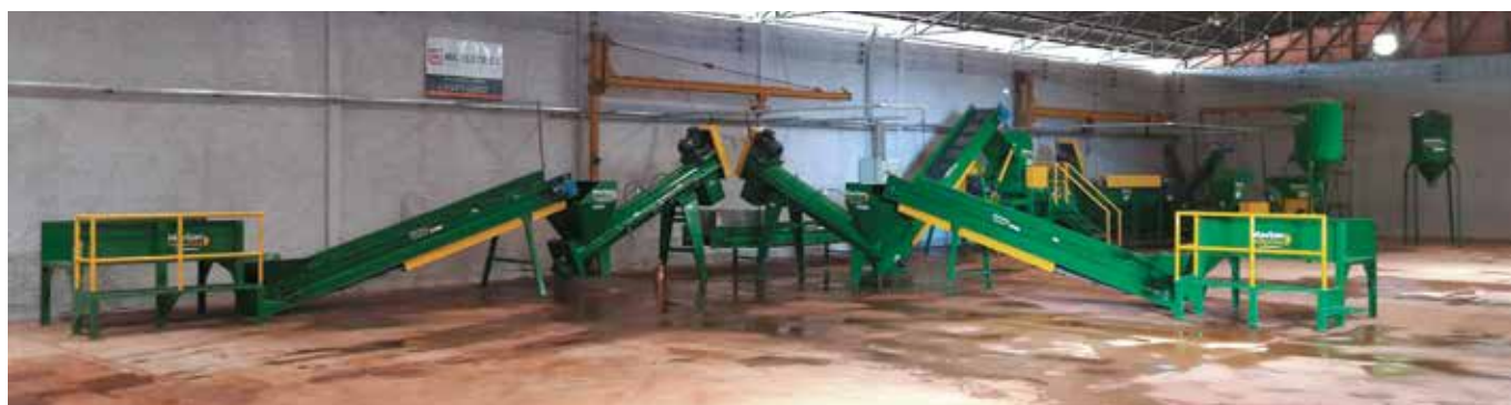
Sistema de reciclagem Marlon: monitoramento eletrônico do consumo de energia.
